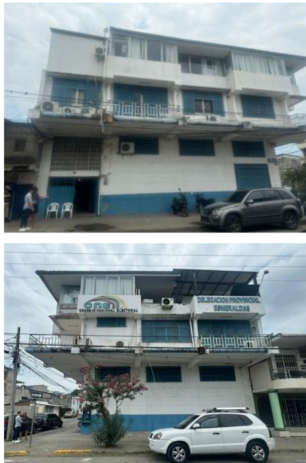
Fig. 17 Fachadas externas deterioradas, del edificio de Delegación Provincial de Esmeraldas
