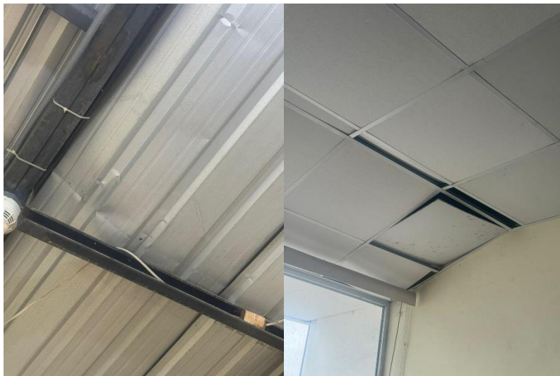
Anexo 2 Desperfectos en cubierta tipo zinc y cielo raso
