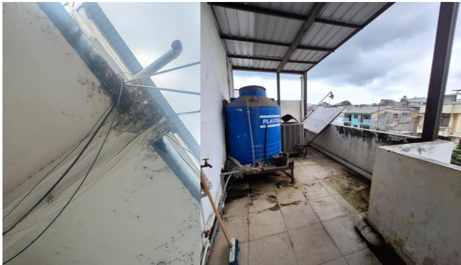
Anexo 4 Humedades y encharcamiento de agua por filtraciones
