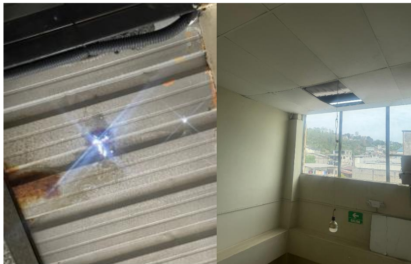
Fig. 14 Cubierta zinc en mal estado
