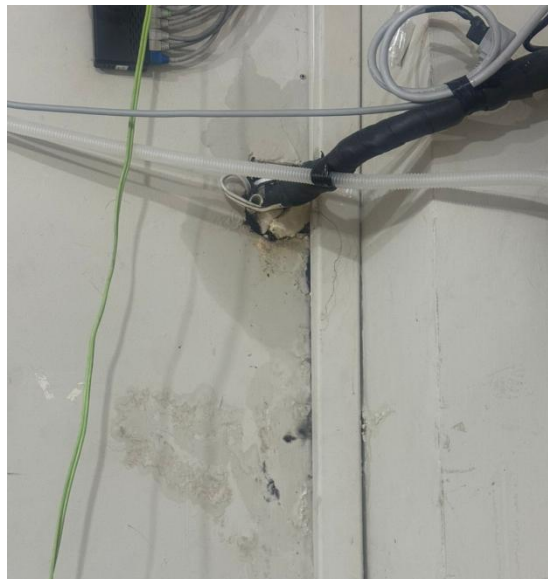
Fig. 16 Fachadas internas con humedad, del edificio de Delegación Provincial de Esmeraldas
