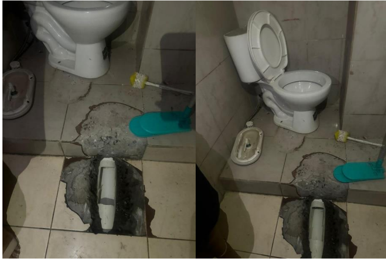
Anexo 1 Inspección baño afectado planta baja
