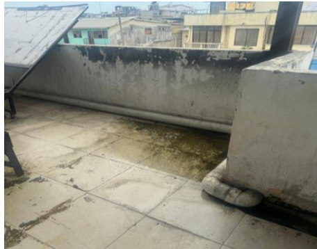
Fig. 13 Encharcamiento de agua
